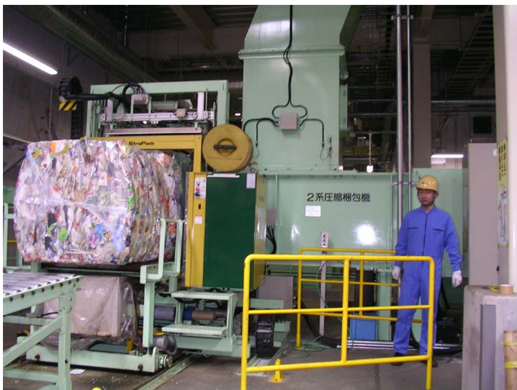
圖九、資源回收場自動化設施
