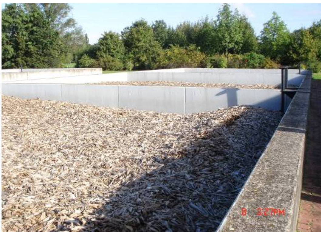
照片五：廢水廠生物活性炭槽實景
