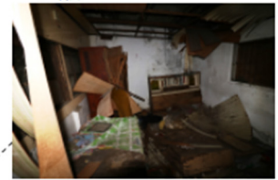
①⑧增建空間牆體構造為磚造牆面，內部破損髒亂。
