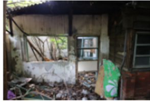
⑪磚造牆體表面水泥粉刷層剝落龜裂。
