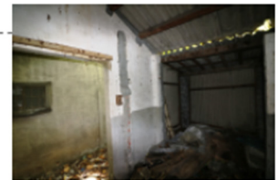
增建之磚造牆面，牆體破損髒汙。
