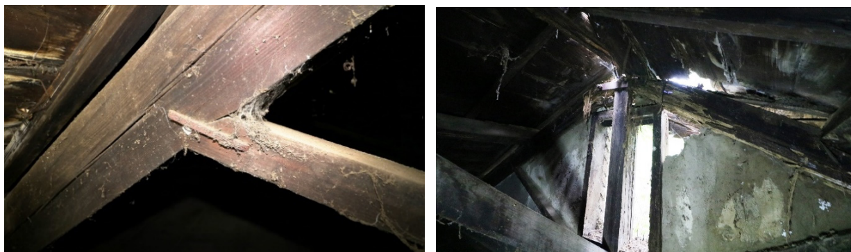
圖4-189 Q棟腰支斜角支撐與合掌接合處、山牆通風百葉破損現況
