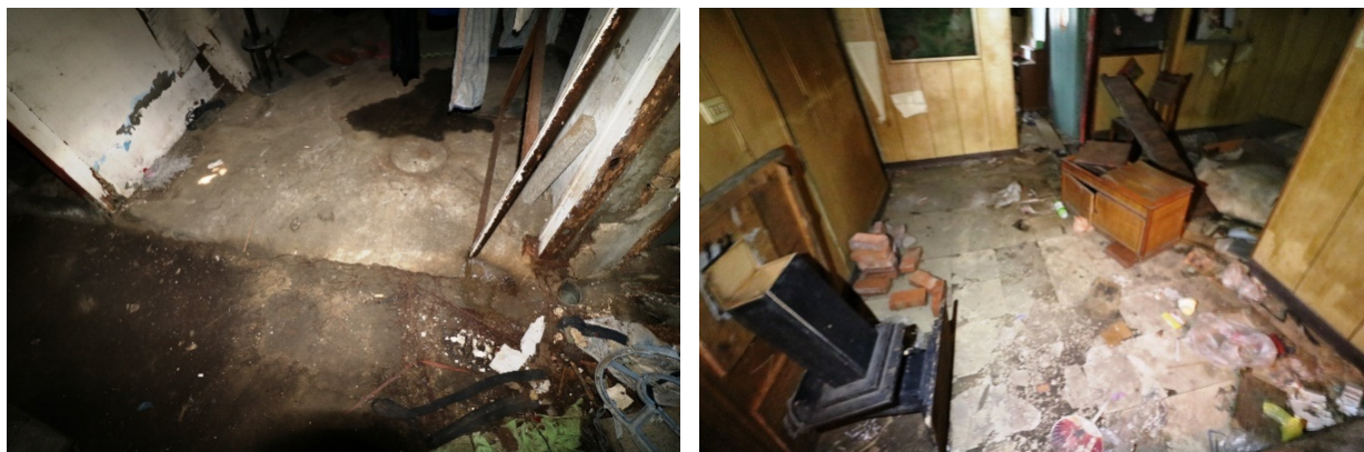
圖4-198 T棟以夯土地坪為主、房間內塑膠地磚表面破損、脫落
