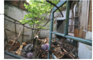
①⑩增建之屋頂坍塌，建物內屋頂構件、廢棄家具四散。
