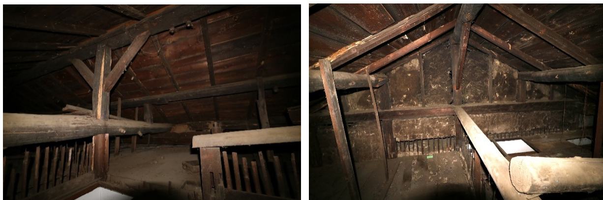
圖4-164 P棟束木可見明顯斷裂痕跡、屋架山牆面現況
