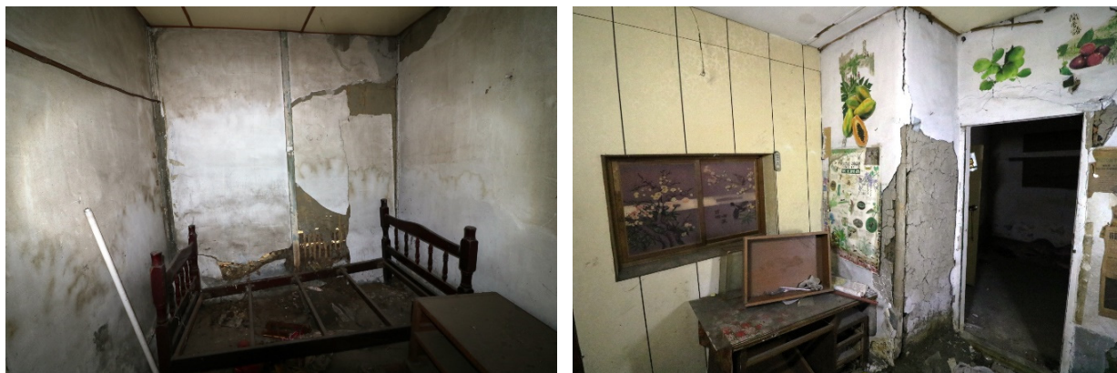
圖4-201 T棟室內牆體破損，竹片外露、壁體表面粉刷層剝落
