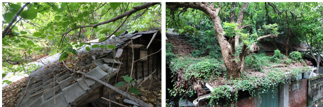
圖4-166 P棟原有屋瓦已改為水泥瓦、9號增建屋已被植物破壞攀附
