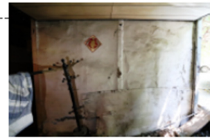
⑥增建空間牆體構造為磚造牆面，內部破損髒亂。
