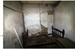
⑧牆體表面剝落，部分土漿流失。
