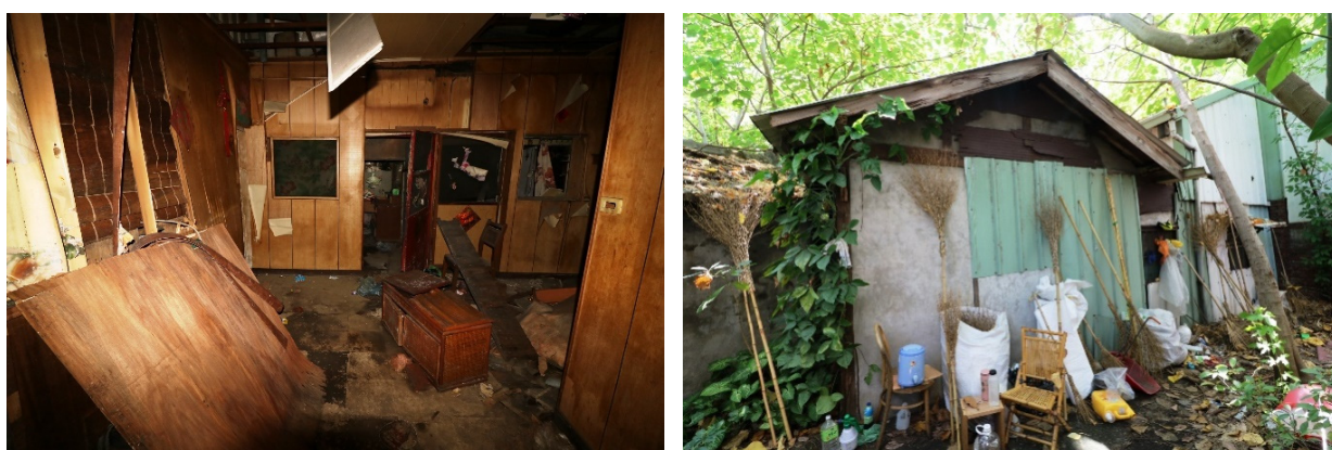
圖4-202 T棟室內木作隔間牆破損、外部牆體表面水泥粉刷修補痕跡
