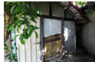
⑤外部立面牆體剝落，竹片外露可見。
