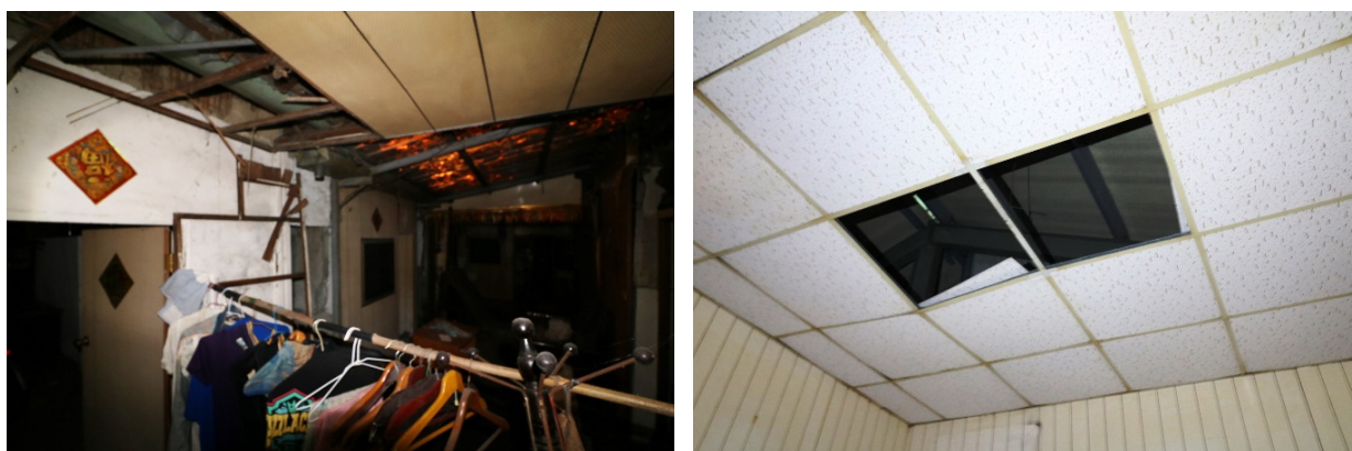
圖4-203 T棟天花板部分修裝面板脫落、輕鋼架天花板也有變形情況
