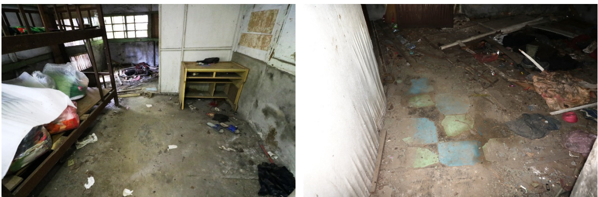
圖4-180 Q棟 10 號入口處磨石子地坪、磨石子地坪表面貼塑膠地磚
