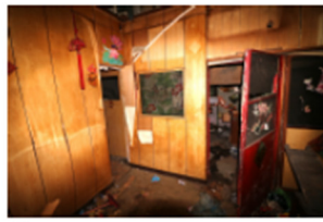
⑩增建隔間牆表面貼附刻溝板，因久置而脫落。
