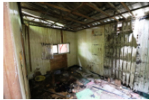
①⑨增建之木作牆表面刻溝板因受潮軟化脫落。
