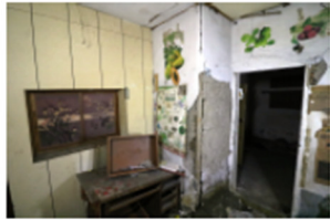
⑨增建牆體表面破損，部分表面貼附刻溝板。
