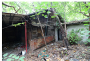
①⑤原有建築體為磚造基礎，雨淋板局部破損佚失。
