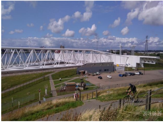
大壩巨型鋼桁架系統（一）
