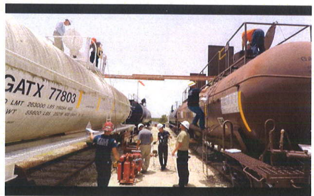
照片 46：圖為 tank car transfer liquefied gas 操作流程，連接兩槽上方閥類，使用空壓機加壓幫浦進行移槽作業。
