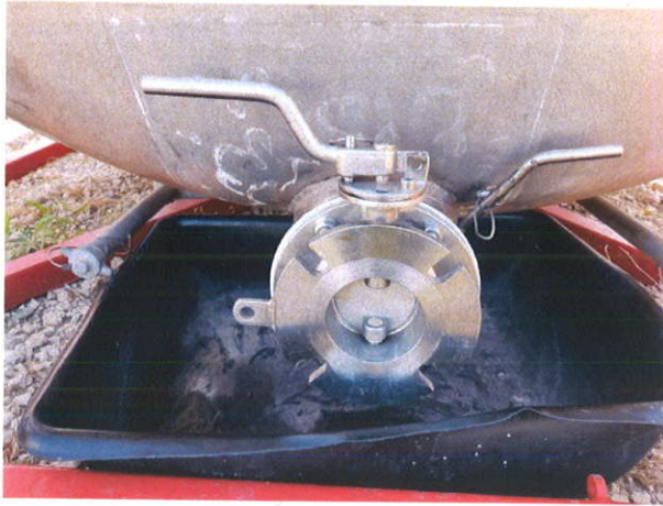
照片 41：圖為 IMO external valve 及 internal valve，為球形閥。
