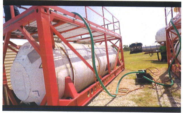
照片 42：圖為 non-pressure IMO transfer 操作流程，連接兩槽上方閥類，使用空壓機加壓幫浦進行移槽作業。
