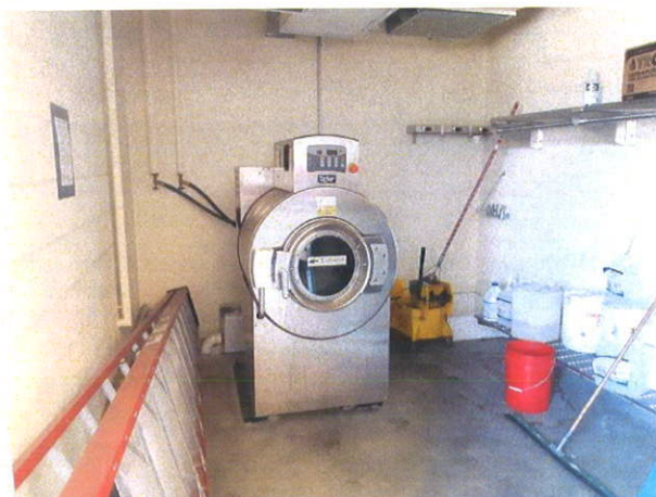
照片4：參訪達拉斯市一般分隊(station 6)，備有消毒室(disinfecting)，清洗消防衣洗衣機。
