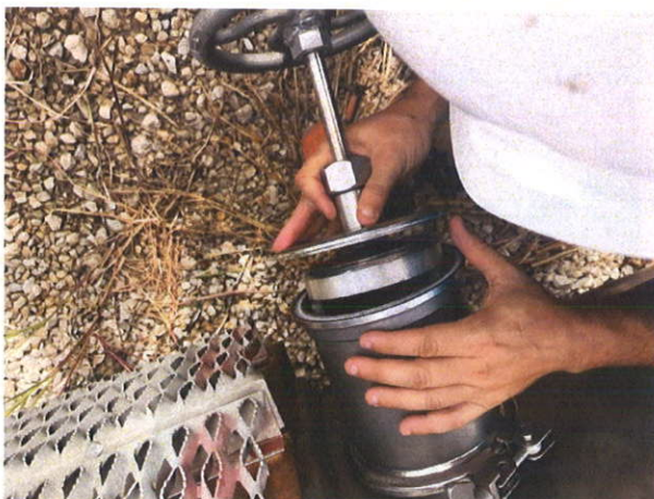
照片 33：圖為 cargo tank clean-out cap 操作流程，側翻槽車之清洗閥會有洩漏情形，透過移槽作業使液面降低。
