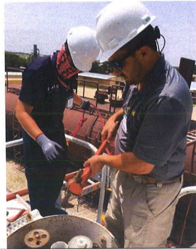
照片48：圖為 tank car transfer liquefied gas 操作流程，槽車上方需連接蒸氣閥、液體閥及 N2 氣體管線。
