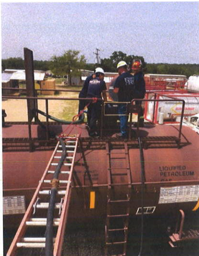
照片49：圖為 tank car transfer liquefied gas 操作流程，兩槽車上方均需連接蒸氣閥、液體閥及 N2 氣體管線。
