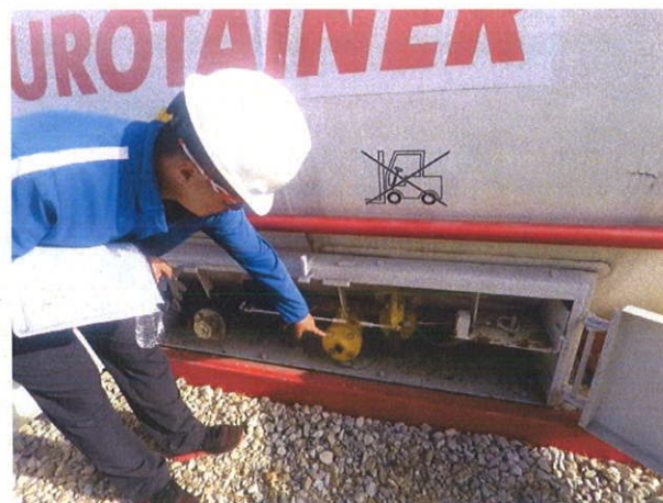
照片39：圖為 IMO 本身即備有之緊急遮斷閥及蒸汽閥。
