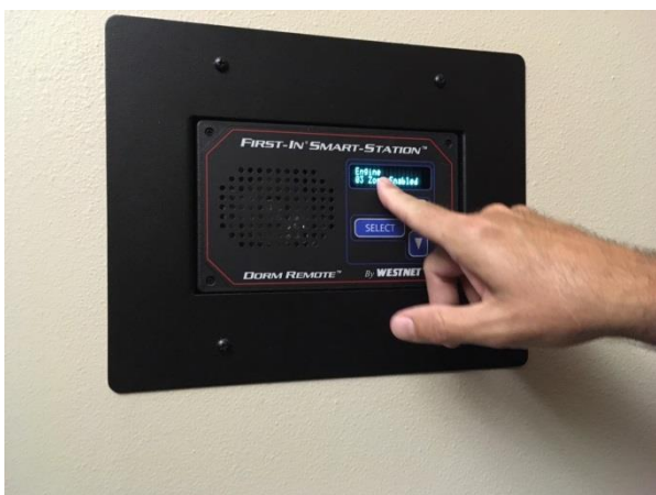
照片15：圖為本局受訓人員參訪當地消防隊，其寢室所設置消防警鈴鳴響分類裝置，透過此裝置能自動分辨不同勤務所需人車做必要警鈴鳴動。
