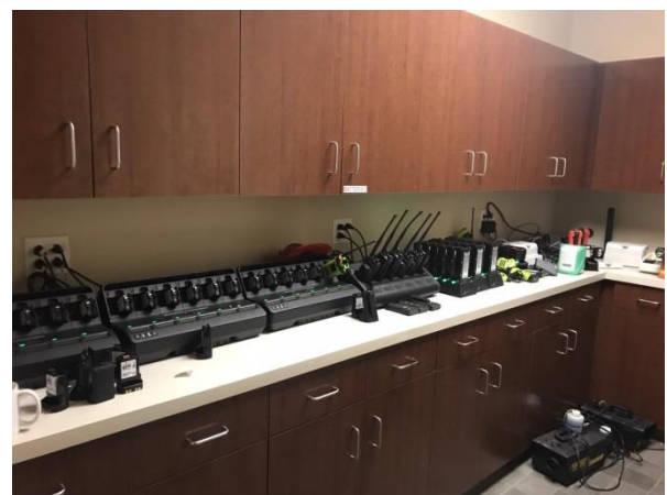
照片14：圖為當地消防隊其無線電室設置情形。
