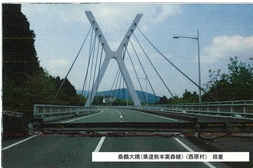
公共土木施設被災状況(橋梁)
