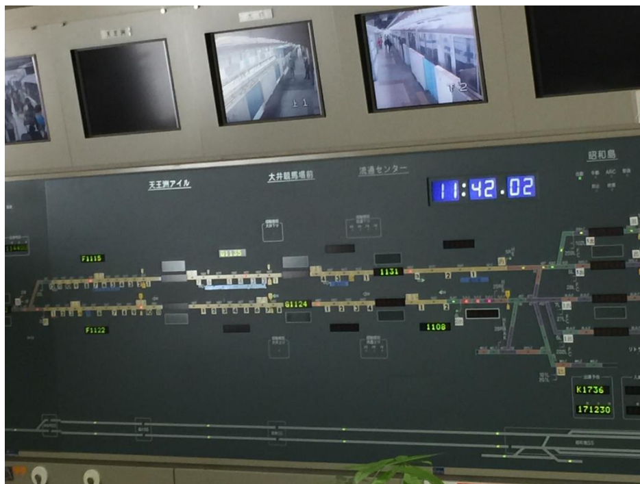
▲ 列車控制中心：監控列車運行，並有螢幕觀看各站內情況。
