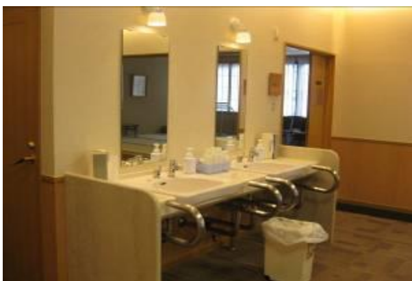
廚房旁設置洗手設備
