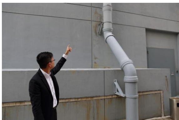
攝影棚外架空之水管（隔絕噪音）
