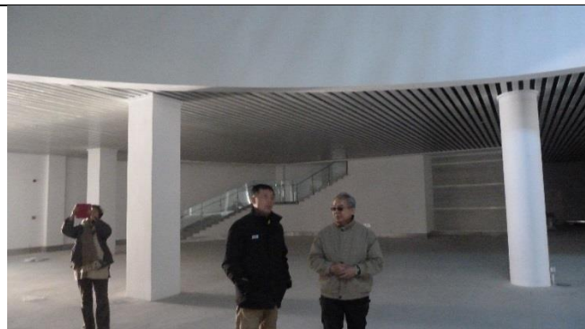
主展館內部挑高不足
