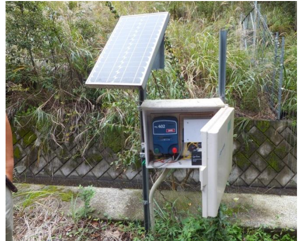
政府公設電器柵欄利用太陽能設備，每 800 公尺設置 1 個
