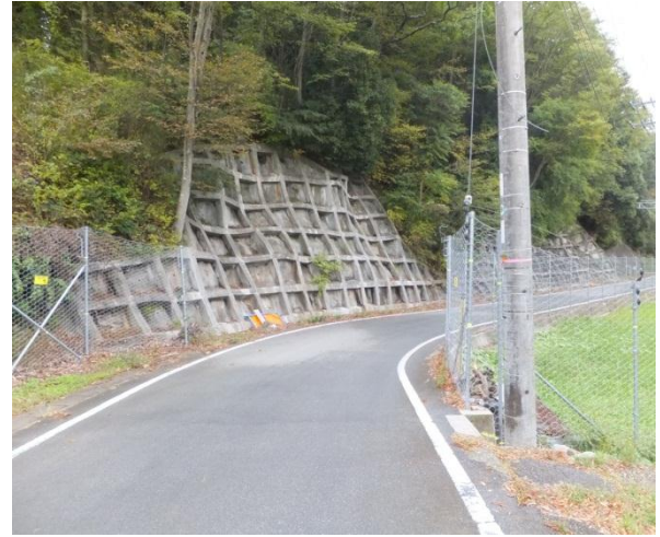
參觀政府公設失敗電器柵欄道路未設柵欄出現缺口
