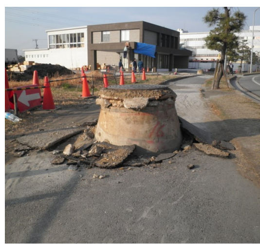
東日本大震災千葉縣浦安市地盤液状 化人孔突出地面
