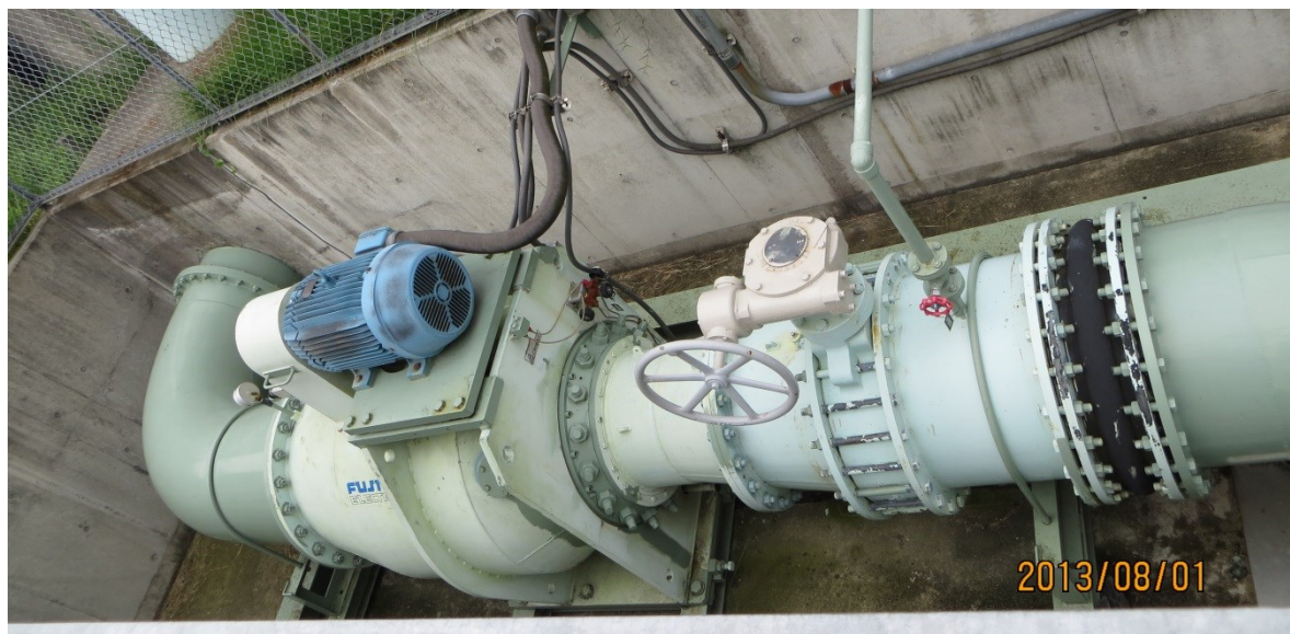
小型水力発電施設
