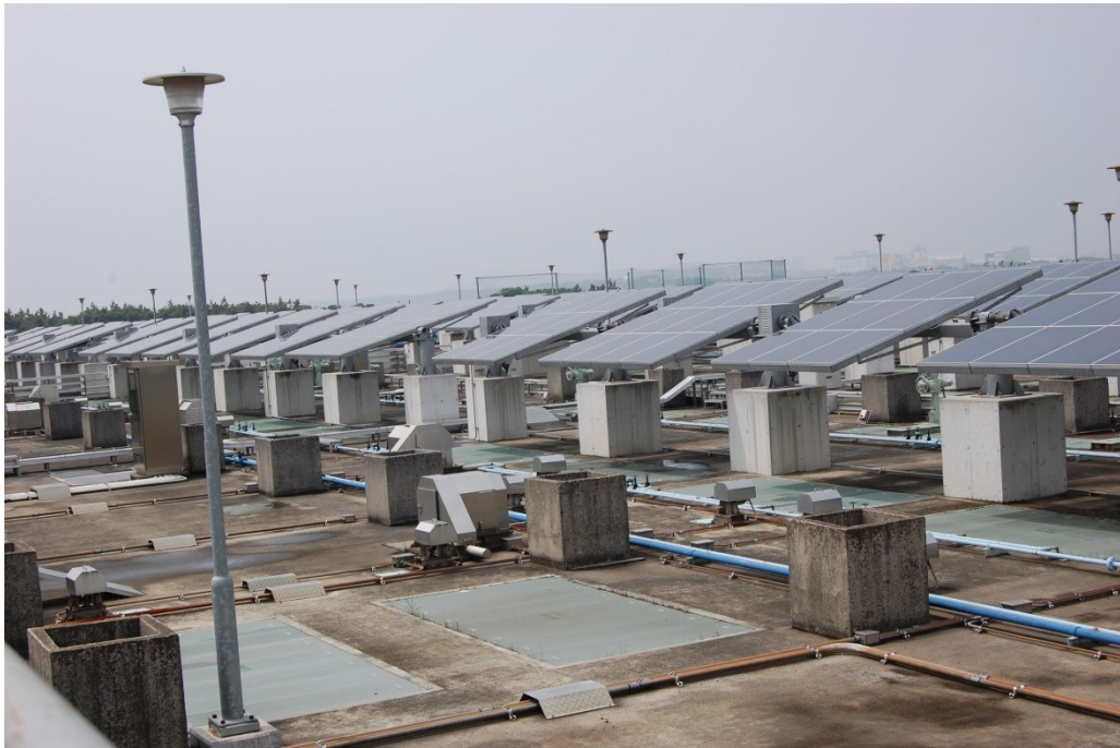
葛西水再生太陽能發電設施
