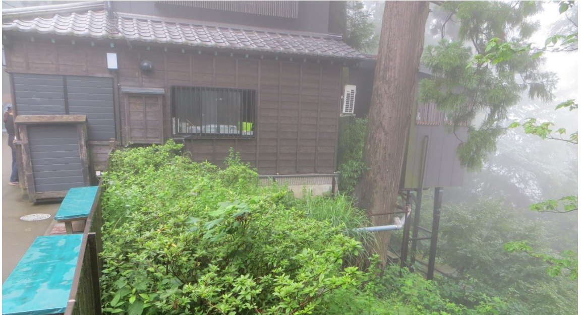
高尾山後巷排水懸空接管
