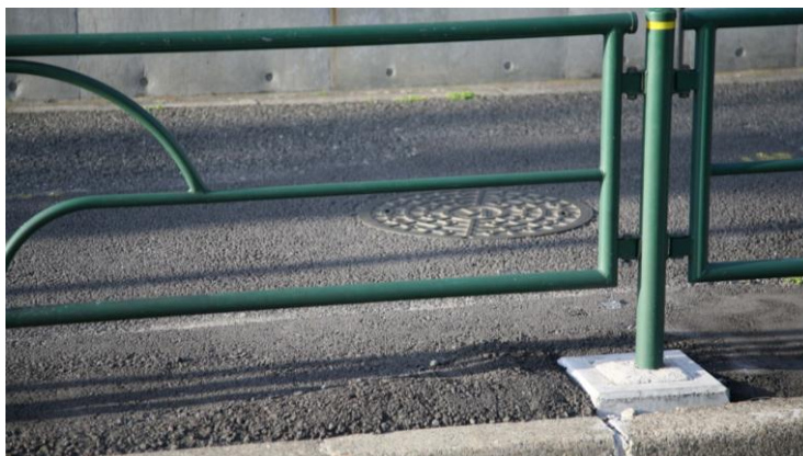
圖2.11 東京都人行道內之人孔蓋設置
