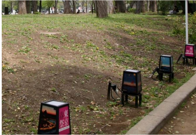
圖2.17 上野公園內景觀燈設置
