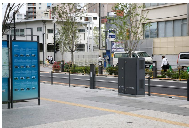
圖2.26 往晴空塔沿線人行道上箱體設置情形
