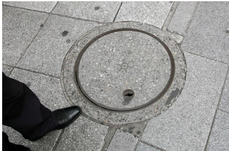
圖2.24往晴空塔沿線人行道上人孔設置情形
