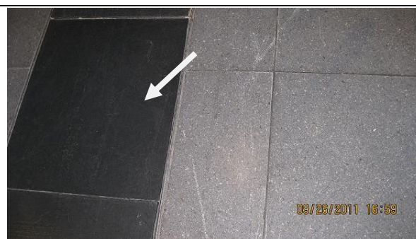
管線鋪設於地面，以活動蓋遮蓋管線
