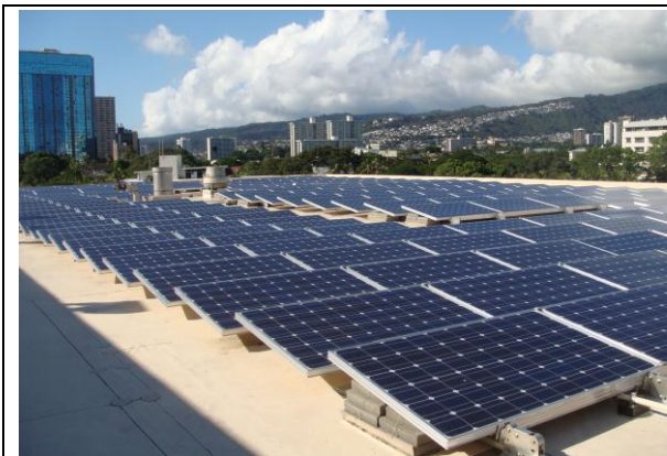
夏威夷州政府頂樓太陽能板設備
