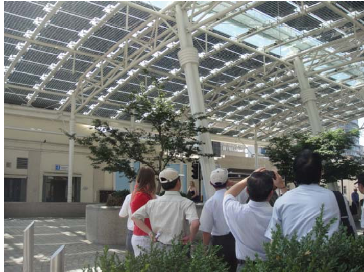
圖九：沃京小鎮造價 2 千餘萬台幣之車站太陽能板
