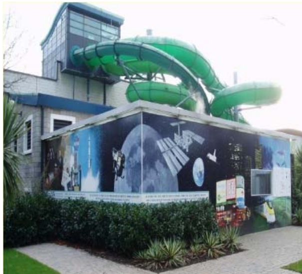
圖三、Woking Park 氫燃料電池及 CHP 發電站外觀
