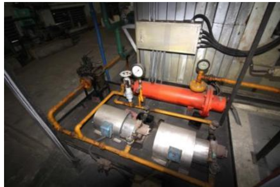
圖 2.4.264 鍋爐機具燃油設施
