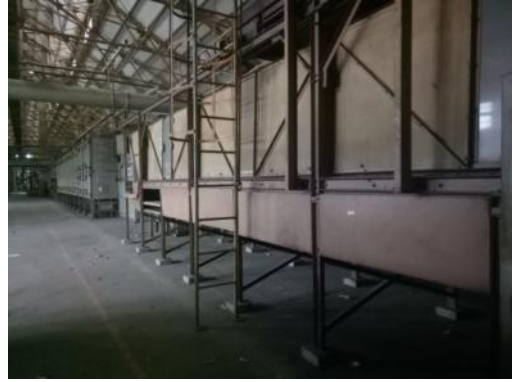
圖 2.4.284 臺中菸葉廠複薰室內複薰機現況 資料來源：本計畫拍攝
