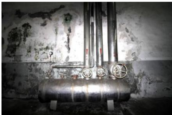
圖 2.4.268 「鍋爐室」冷熱水管線設備現況 資料來源：本計畫拍攝
