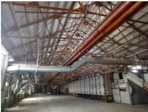
圖 2.4.275 複薰工場內部複薰機與鋼構棚架屋頂現況
