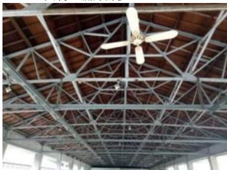
圖 2.4.423 製材工廠鋁製桁架現況
