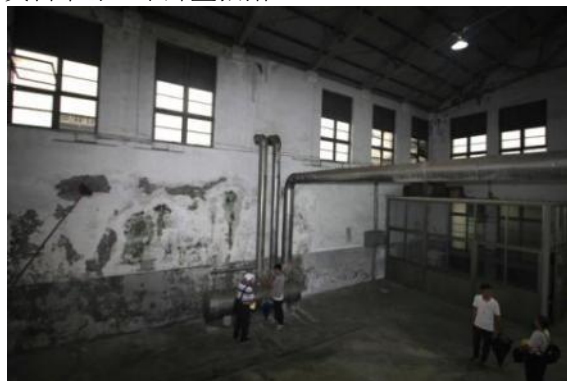
圖 2.4.269 「鍋爐室」冷熱水管線現況 資料來源：本計畫拍攝
