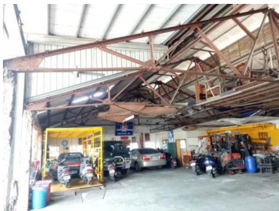
圖 2.3.43 位於吉隆段 807 地號及 809 地號上的老舊廠房內部-可見布滿鐵鏽的鐵桁架
