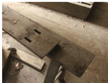
【照片 3】單一長板凳支架卡榫脫離
