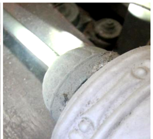
【照片 3】燈具表面沾染灰塵嚴重
