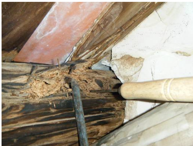
【照片 5-6-8】後落左盡間屋桁遭褐腐劣化
