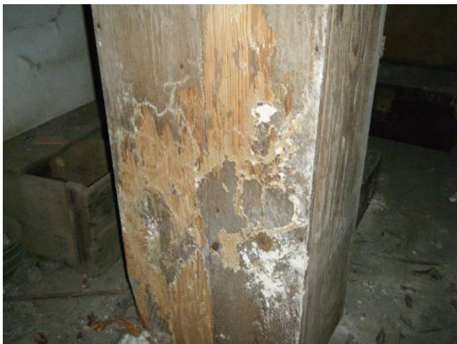
【照片 5-6-9】木箱遭白蟻危害
