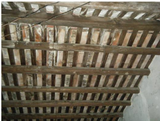
【照片 5-6-5】屋頂滲漏水漬殘留屋桁表面
