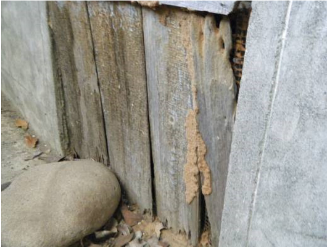
【照片 5-6-13】左外護龍通風口木板遭土白蟻危害
