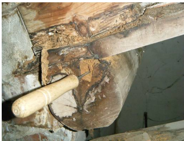
【照 5-6-10】前落明間屋桁端部遭白蟻危害
