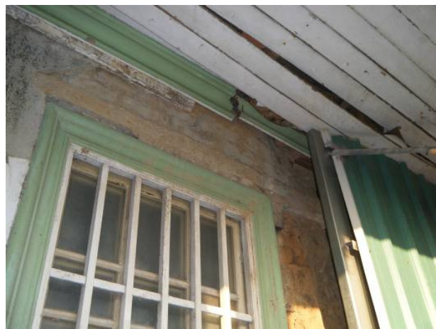
【照片 5-6-7】前落右稍間牆體土塊崩落
