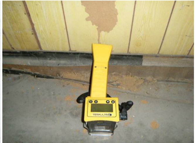
【照片 5-6-14】微波白蟻偵測儀檢測前落左梢間木隔間土白蟻危害處未發現活體
