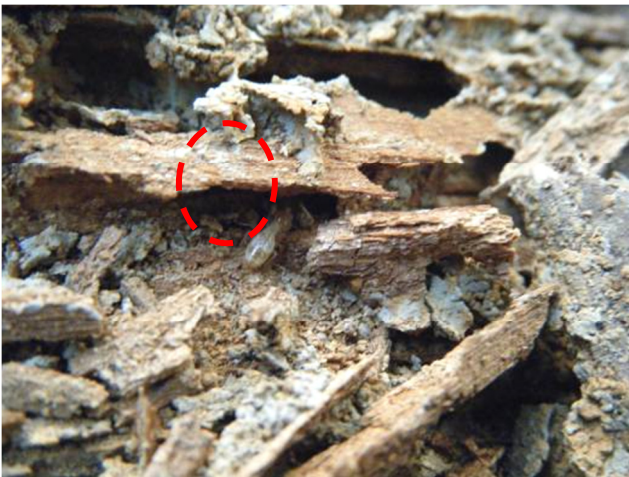
【照片 5-6-15】後落倒塌屋桁發現土白蟻活體
