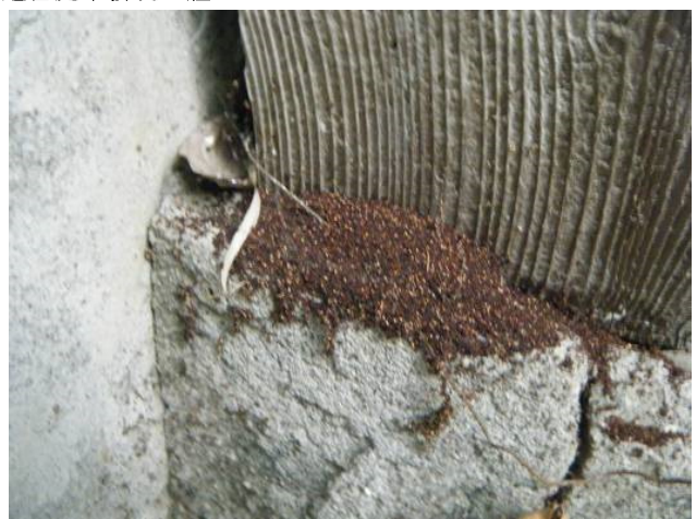
【照片 5-6-16】左外護龍過水廊發現乾木白蟻危害
