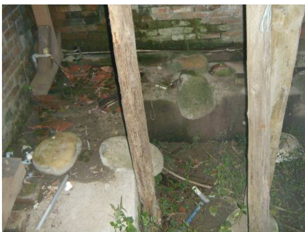
【照片 5-6-1】水流漫進基地東北側，造成潮濕及泥沙淤積
