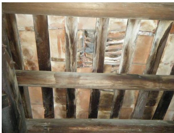
【照片 5-6-6】左外護龍廚房瓦養破損
