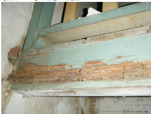
【照片 5-6-11】前落右稍間樓桁遭白蟻危害
