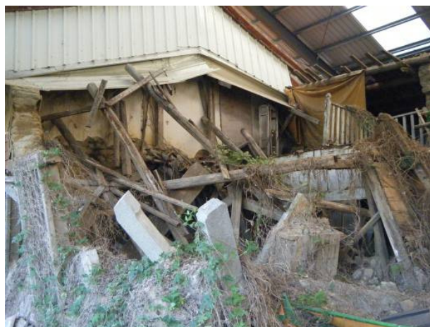
【照片 5-6-4】後落倒塌空間未清理
