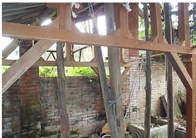
【圖 4-8-10】原有屋頂已損壞
