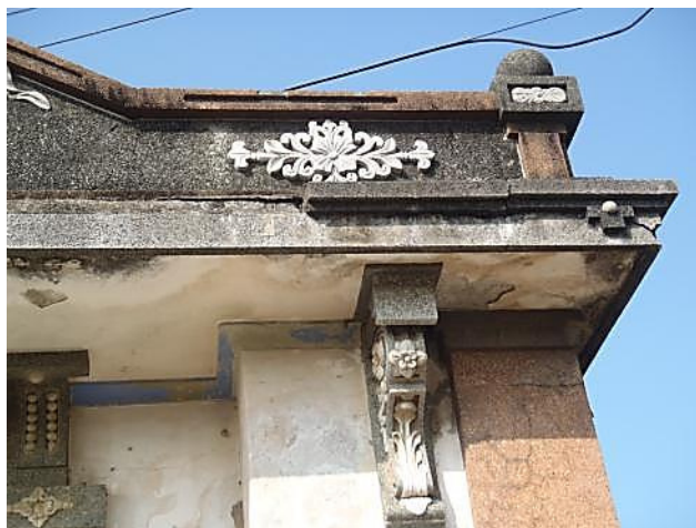
【圖 4-8-4】雨庇受潮粉刷層剝落
