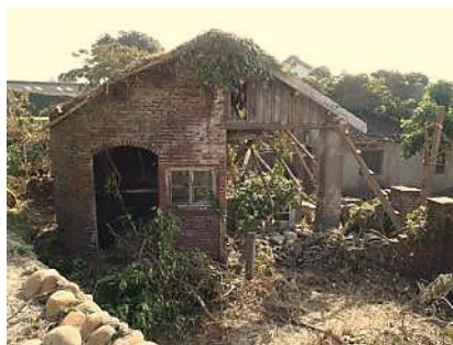
【圖 4-8-7】宅地右後側倒塌的豬舍和廁所
