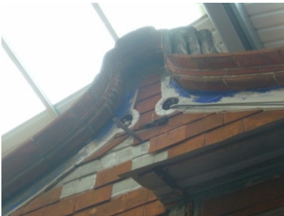
【圖 4-7-67】屋頂山牆設置通氣孔
