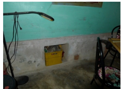
【圖 4-7-75】第一進左次間通氣孔堆放雜物
