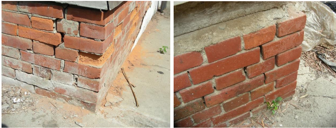
【相 7-4.11】日式木造宿舍磚砌勒腳牆角隅處損壞狀況
