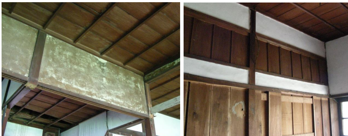
(1) 部分欄間剛度不足或重量較大而產生潛變
