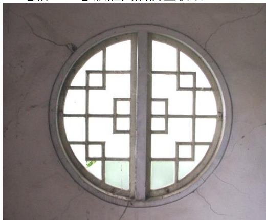
【相 7-2.3】牆體開口部開裂破壞
