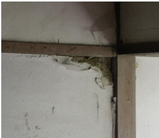
【相 7-2.1】牆體角隅擠壓破壞
