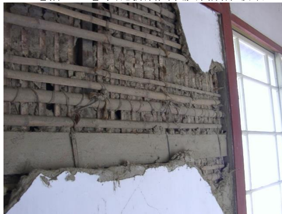
【相 7-2.4】土壁崩落破壞
