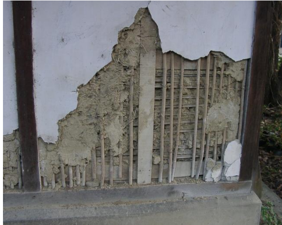
【相 7-2.2】灰泥粉刷開裂及剝離破壞
