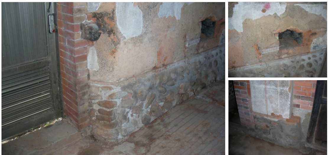
牆面裝修剝落處可見牆體為土塼砌築而成
