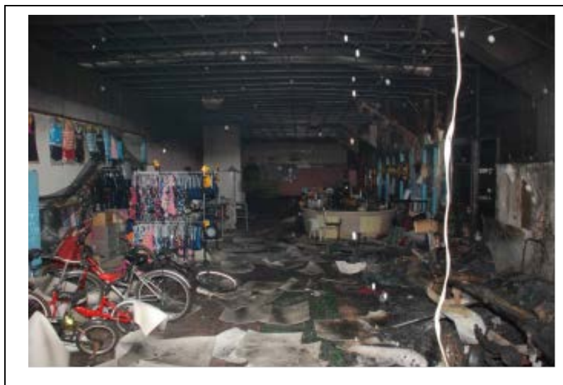
圖 3-19 101 號 1 樓僅前側門口處受火熱輕微燒損
