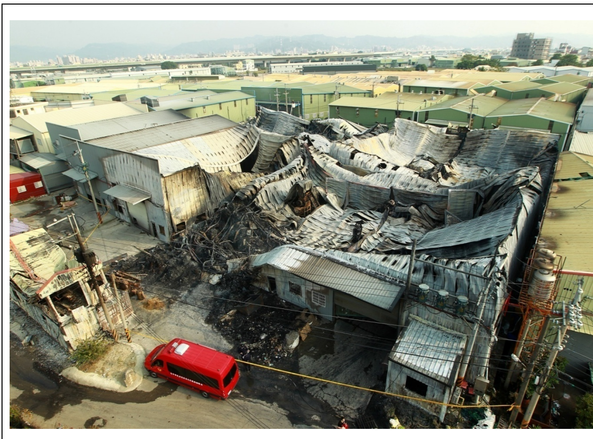
圖 3-27 鐵皮屋火害後崩塌
