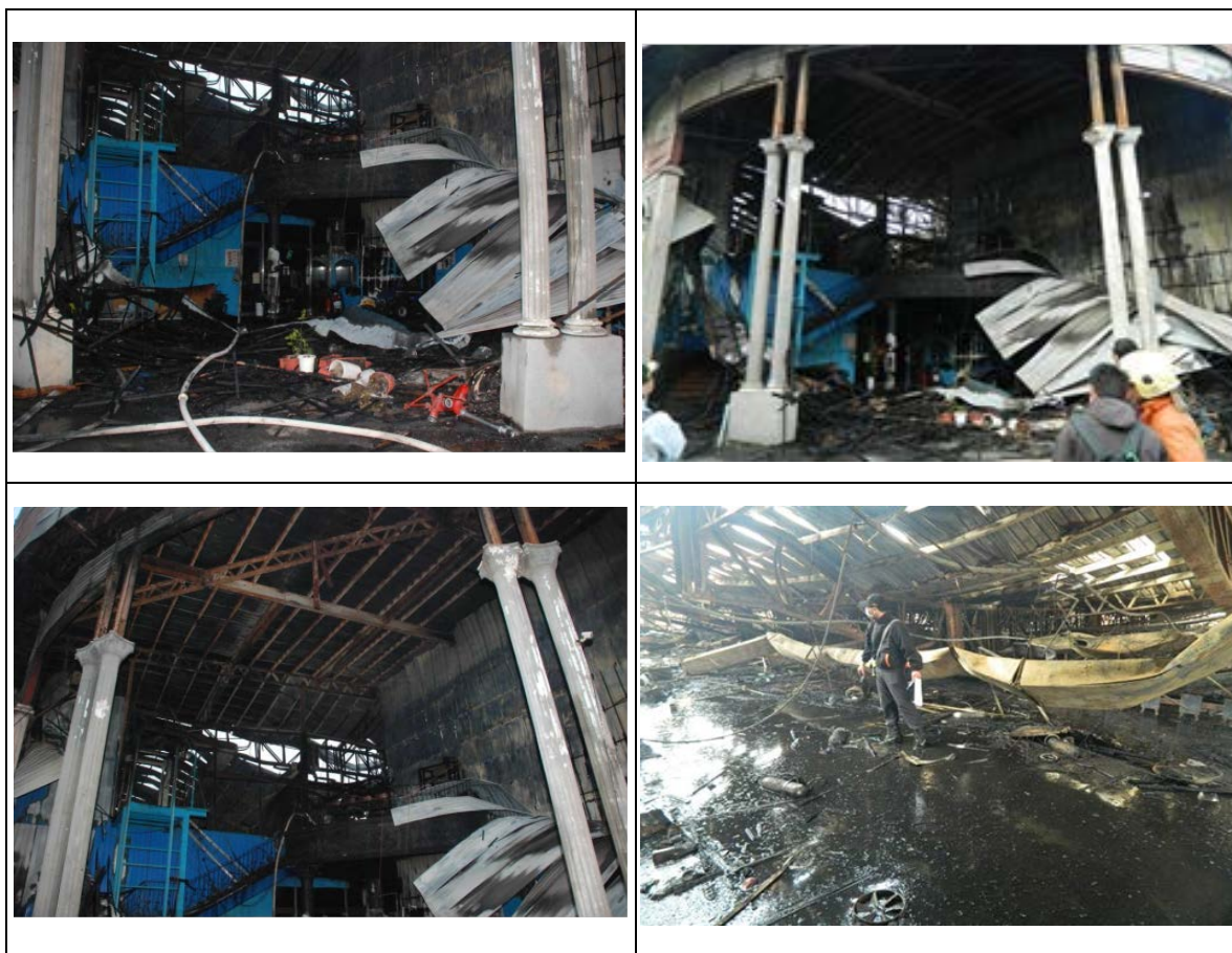
圖 3-15 建築物內部受燒情形
