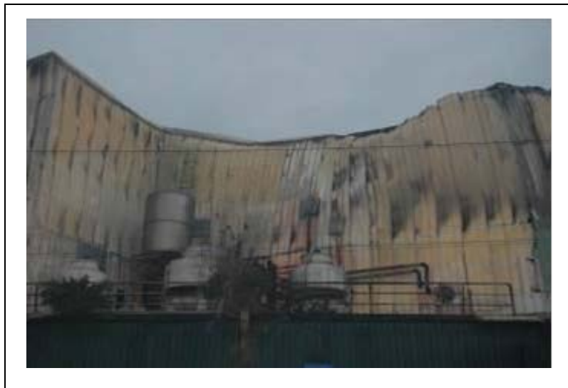
圖 3-18 檢視起火建築物後側外觀，屋外鐵皮明顯受燒變形氧化
