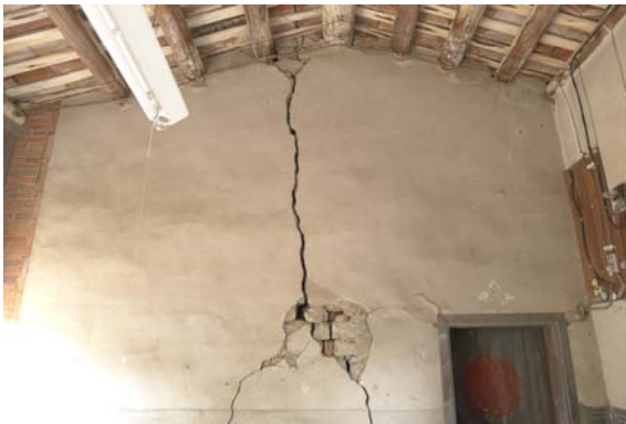
照片 3-3-19：門廳隔斷牆地震後受損（本研究攝）
