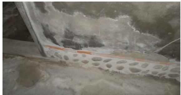
照片 3-4-2：土塼造牆體現貌（本研究攝）
