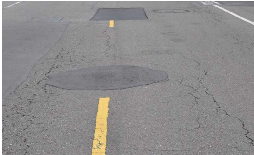
圖 3.11 兩手孔間距適當大時鋪面結構系統面層局部凹陷與龜裂情形
