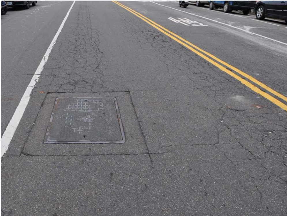
圖 3.4 鋪面結構系統埋設管線引發之面層局部凹陷與龜裂情形
