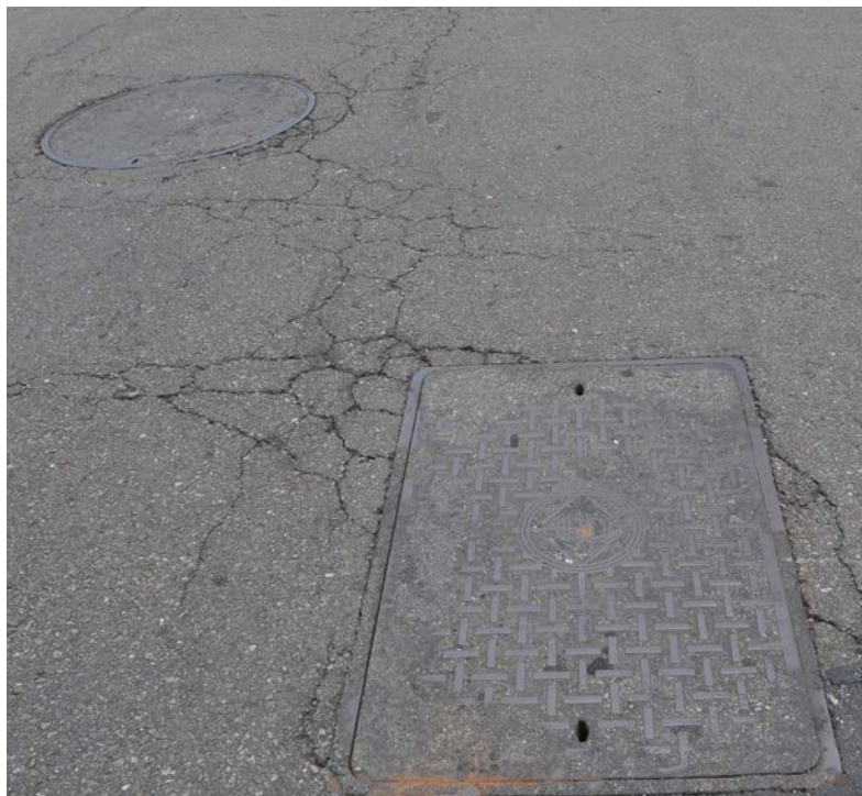
圖 3.10 兩手孔間距過小時鋪面結構系統面層局部凹陷與龜裂情形
