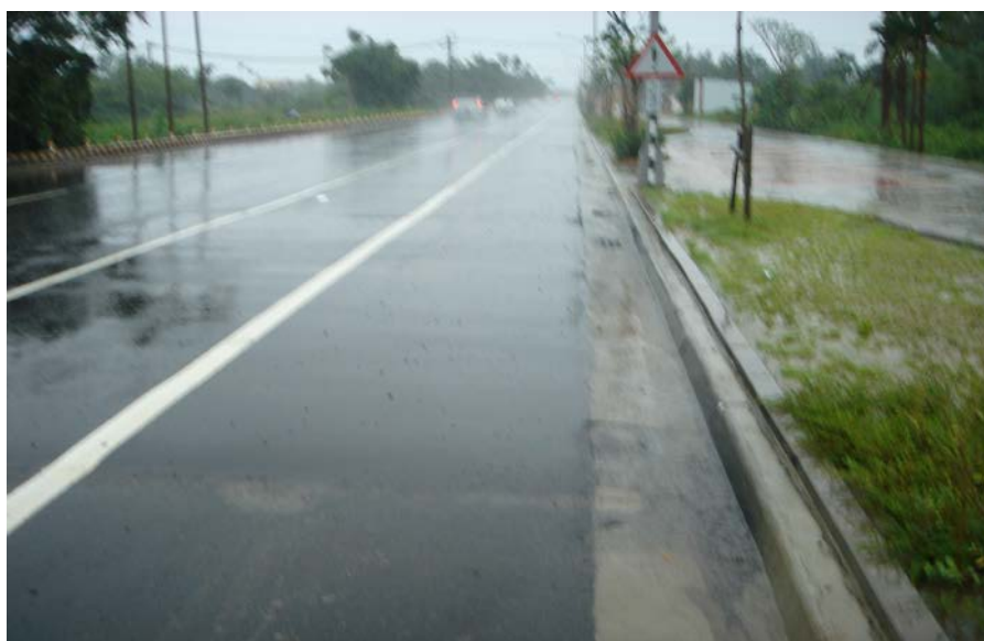
圖 3.6 雨水在景觀步道植栽區匯集後朝一側鋪面結構系統滲流造成鋪面結構系統局部流動變形、凹陷及龜裂後修補情形
