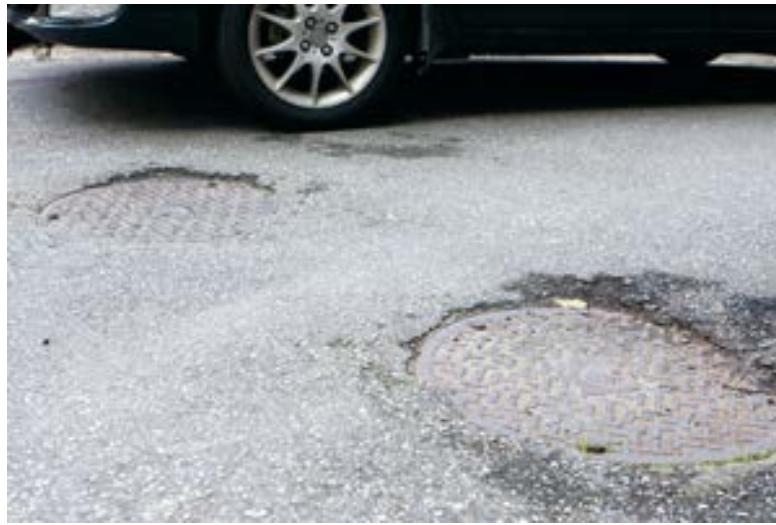
圖 3.9 手孔凹陷情形
