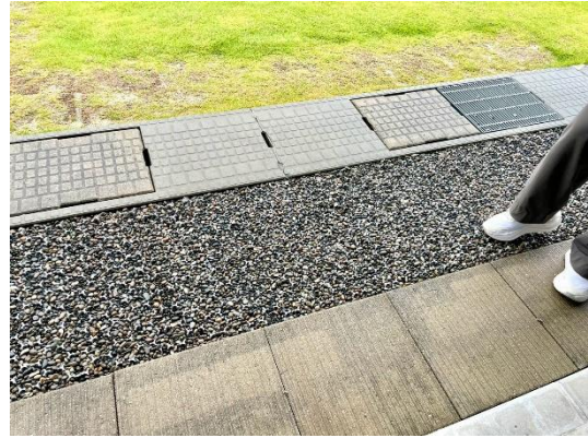
里山里海博物館戶外排水設施
