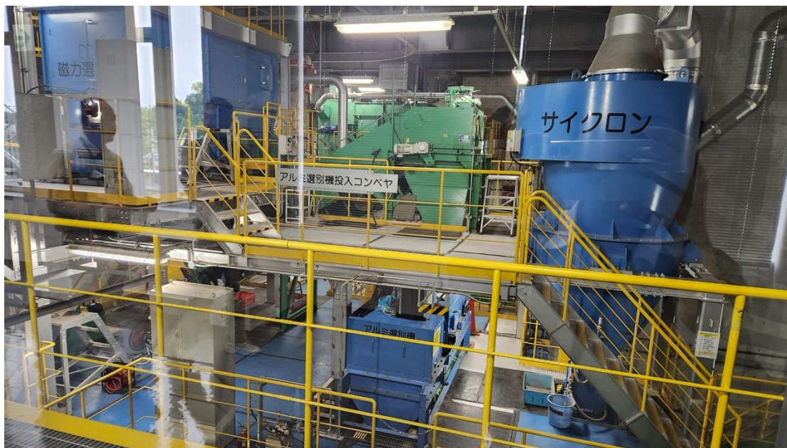
圖 14、町田市熱能回收中心分選設施
