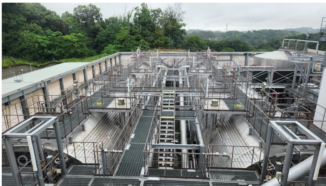
圖 15、町田市熱能回收中心橫躺式發酵設施（左右各 1）
