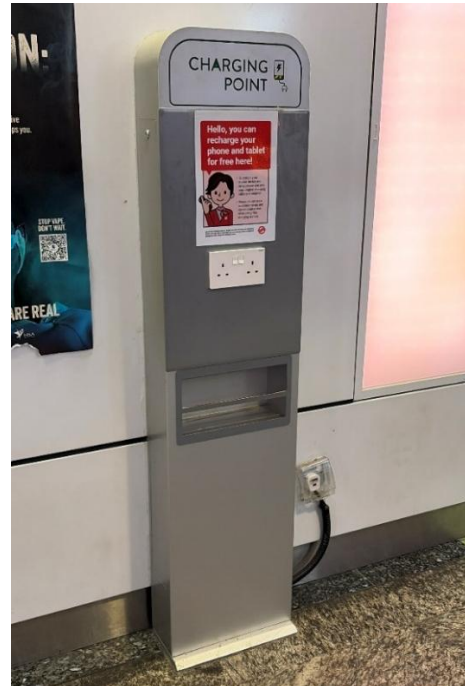
圖 18 地鐵站免費充電設施
